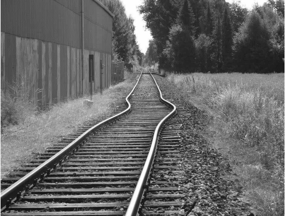
Gleisverwerfung auf der Teutoburger Wald-Eisenbahn (TWE) am ehemaligen Bahnhof Gütersloh Ost (ABproTWE/wikicommons)
